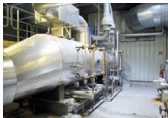
La combustion des déchets produit de l'énergie thermique utilisée par le réseau de chauffage urbain.
